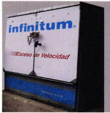
Caja de Distribución de TELMEX
