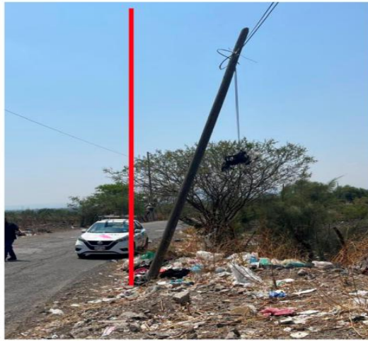
Figura 3.2: Infraestructura sin mantenimiento que el AEPT ofrece a través de la ORCI EM (2/3) [Fuente: Elaboración propia, 2025]
