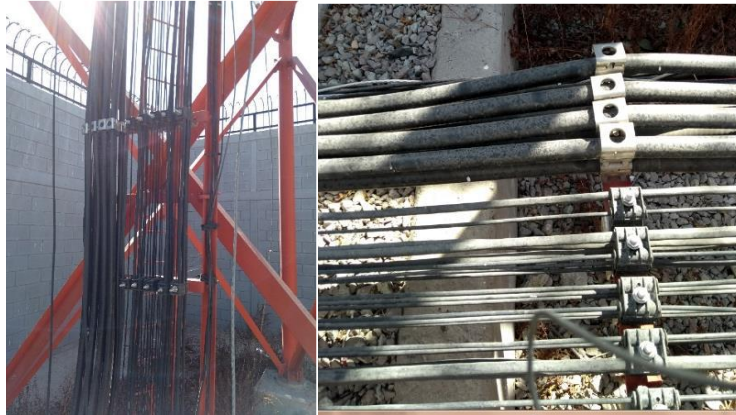
Figura 3. Guías de onda, camas de cables y cables sujetos con Hangers
